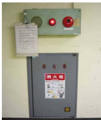
図4 火災報知器（上）と消火栓（下）
