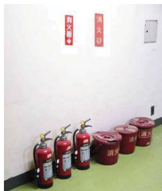
図5 消火器と消火砂
