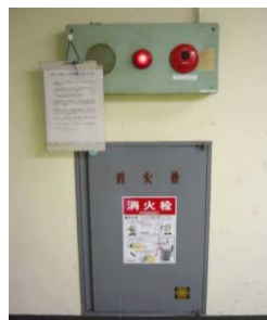
図6 火災報知器と消火栓
