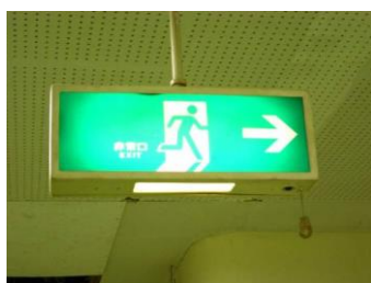
図4 避難経路を示す誘導灯
