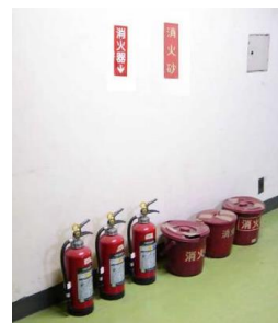
図7 消火器と消火砂
